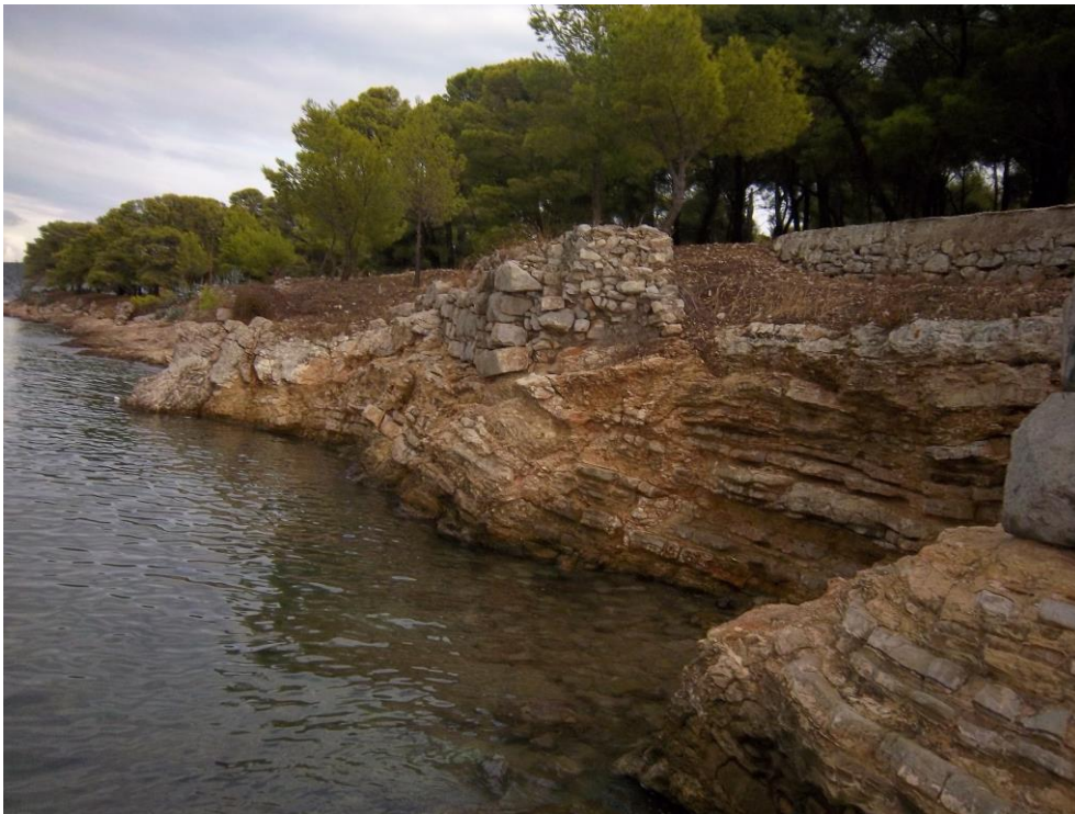
Εικόνα 22. Θέση όπου η θάλασσα έχει υποσκάψει το τείχος πριν αιώνες.
