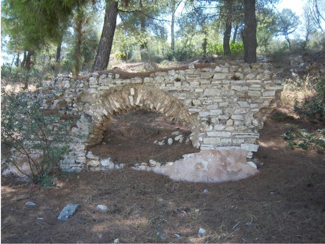
Εικόνα 38. Δυστυχώς οι καμάρες είναι έτοιμες να καταρρεύσουν, ενώ μερικές ήδη έχουν καταρρεύσει.
